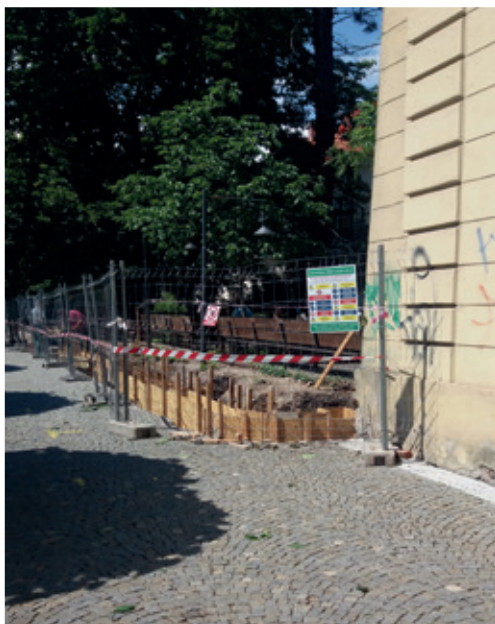
Obr. 29 správně ohraničená překážka na komunikaci
