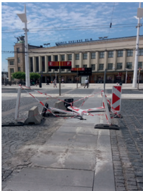
Obr. 28 nesprávně ohraničená překážka na komunikaci
