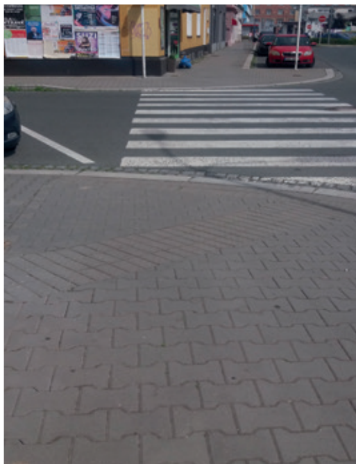
Obr. 34 příklad nesprávného řešení signálního pásu přechodu (špatné směrové vedení, nektrastní)
