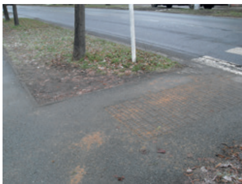
Obr. 07 nevhodné řešení signálního pásu u přechodu (nekontrastní a není ukončen u vodicí linie)
