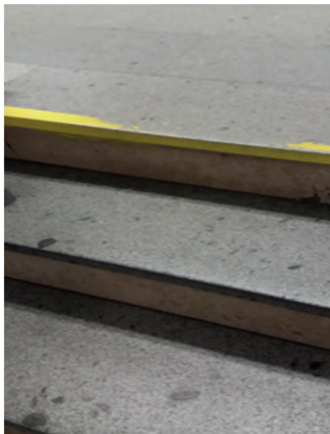
Obr. 24 nesprávné řešení vizuálně kontrastního označení schodiště (kontrastní označení je i na podstupnici a na náslapné hraně je setřelé)
