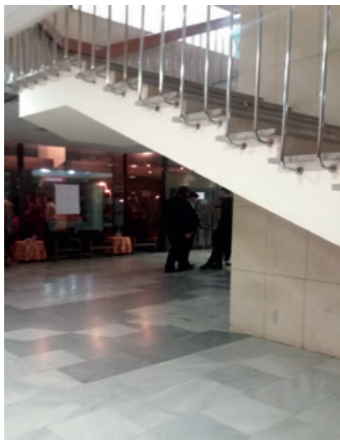
Obr. 31 příklad nezabezpečeného schodiště v prostoru
