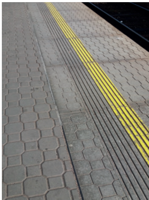
Obr. 12 vodící linie s funkcí varovného pásu na železnici
