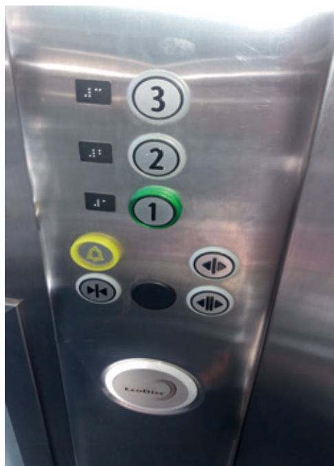
Obr. 16 ovladač v kleci výtahu – částečně správné řešení (Braillův znak má být vpravo od ovladače)
