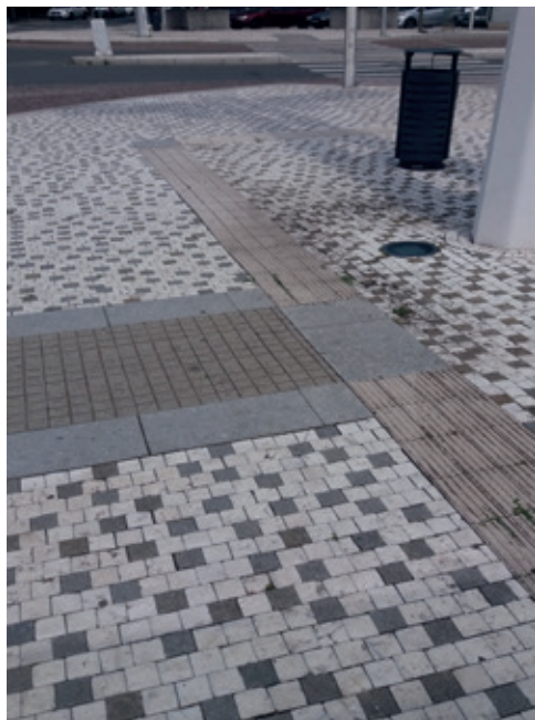
Obr. 04: umělá vodicí linie v exteriéru
