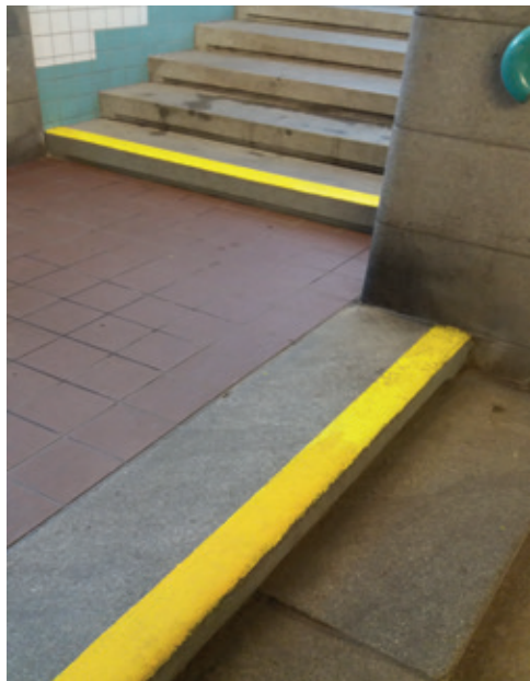
Obr. 23 správné řešení vizuálně kontrastního označení schodiště
